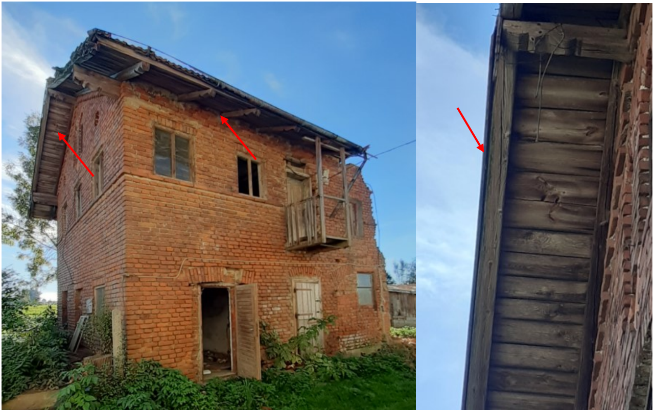
Abb. 3: Potenzielle Fledermausverstecke zwischen Brettern und Dacheindeckung sowie im nicht begehbaren Dachboden (links). Rechts: Potenzielles Fledermausversteck zwischen Balken und Windbrett
